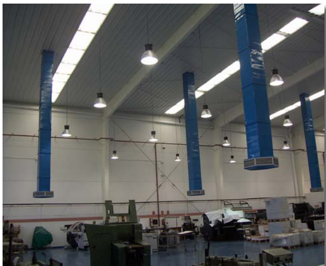
imagen de instalación de 6 equipos BREEZAIR Serie TBA en Gráficas San Pancracio, Málaga.
